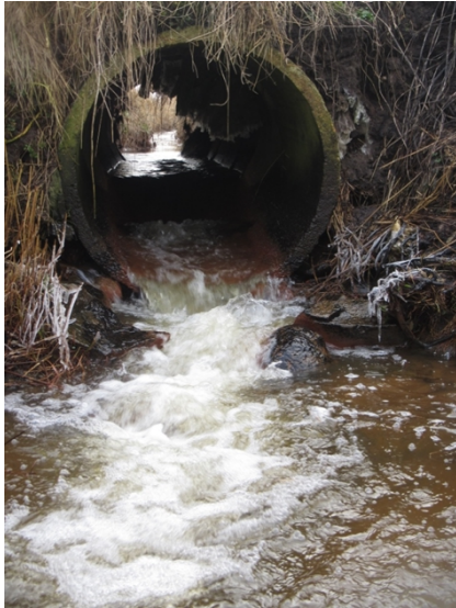
Figur 3. Defekt røroverkørsel i st. 7284. Overkørslen fjernes i forbindelse med projektet, da den ikke bruges længere. Faldet udlignes over 140 m ved udlægning af gydegrus og skjulesten.
